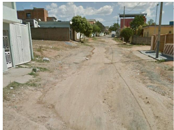
Via sem pavimentação
