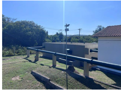
Tanque de contato
