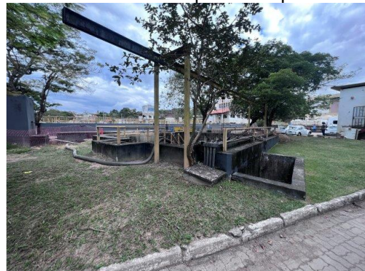
Estrutura para UTR
