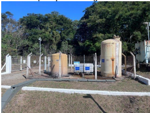
Armazenamento de produtos químicos
