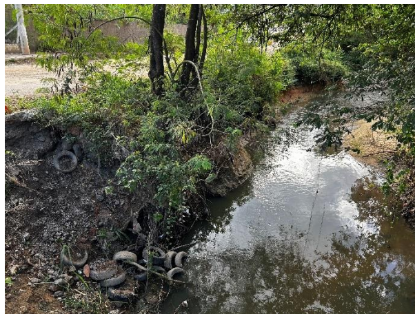
Erosão a montante da rua João Del Rei
