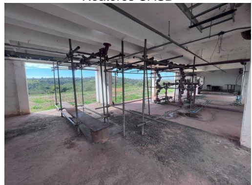
Desidratação do lodo
