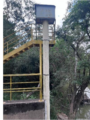
Estrutura de aferição de nível automatizada
