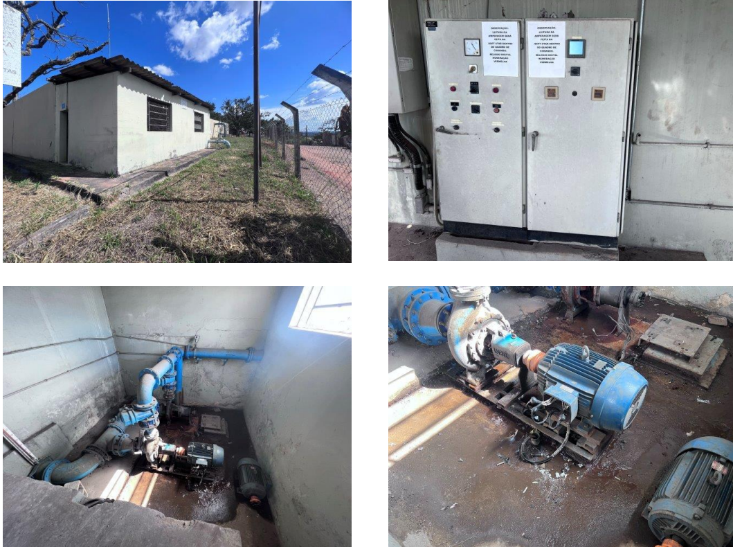
Figura 29 - EEAT R4. Fonte: SERENCO.
