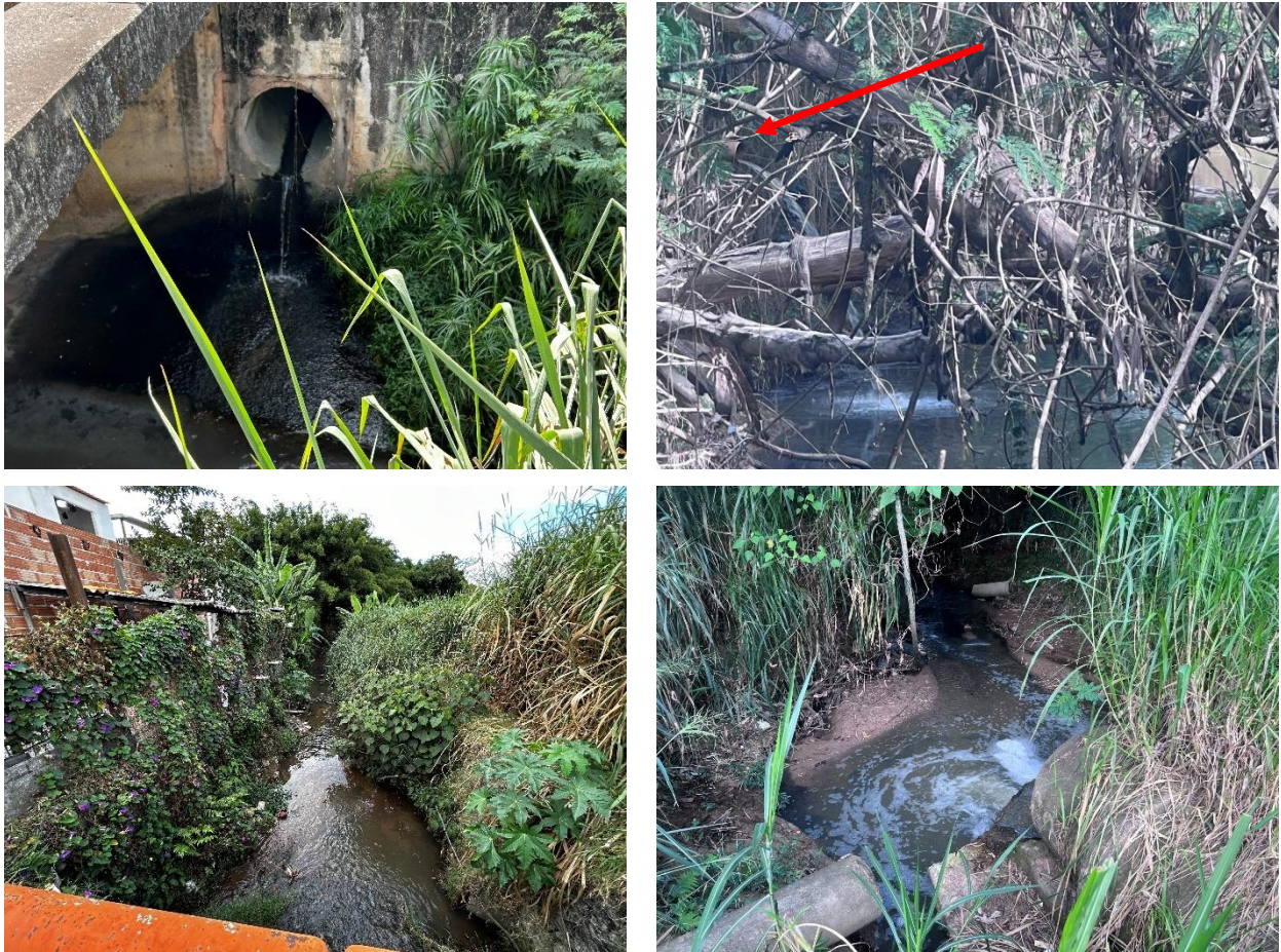
Figura 11 - Lançamentos de esgoto nos córregos e canais.
