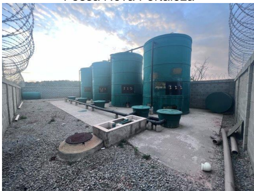
ETE Portal Vila Jardim
