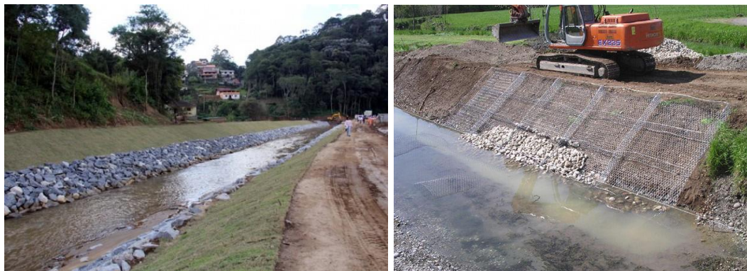
Figura 47 - Exemplos de proteção dos taludes em córregos.
