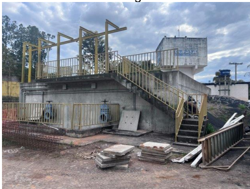
Estrutura para UTR
