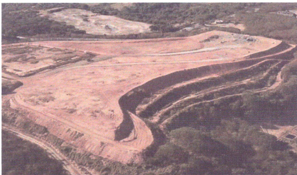
Figura 3 - Segundo documento do CIAS, não foi informado pela prefeitura nenhum estudo geotécnico deste maciço.
